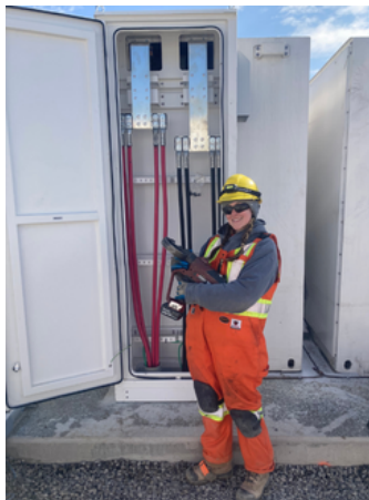
Rory McDonald, V3 BESS Site
